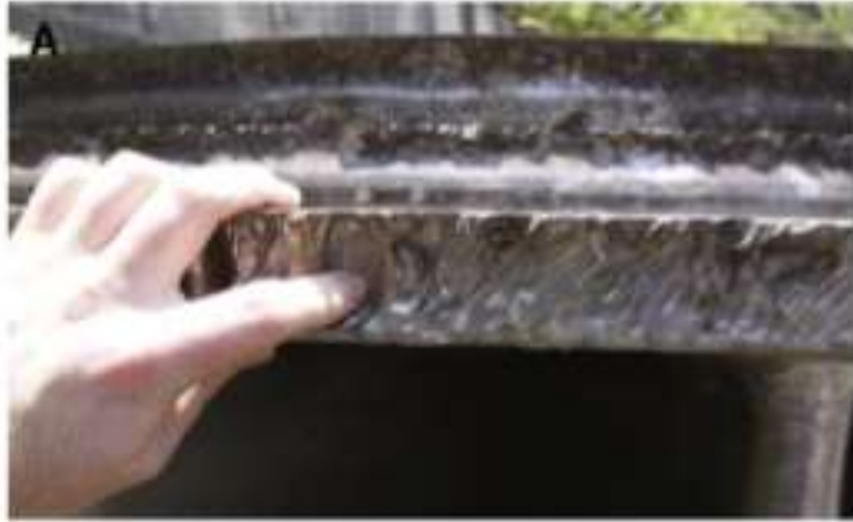
写真2. アゴヤン水力発電所での火山灰によるタービンの摩耗の様子 88)
